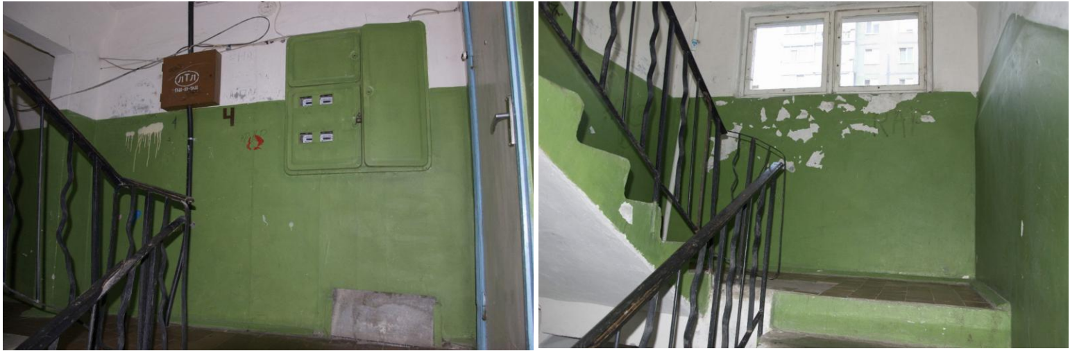
Фото до ремонту
